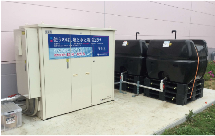
工場屋外にESS-300を設置。酸性電解水・アルカリ性電解水それぞれを1トントタンクに貯め館内各所に供給している。
